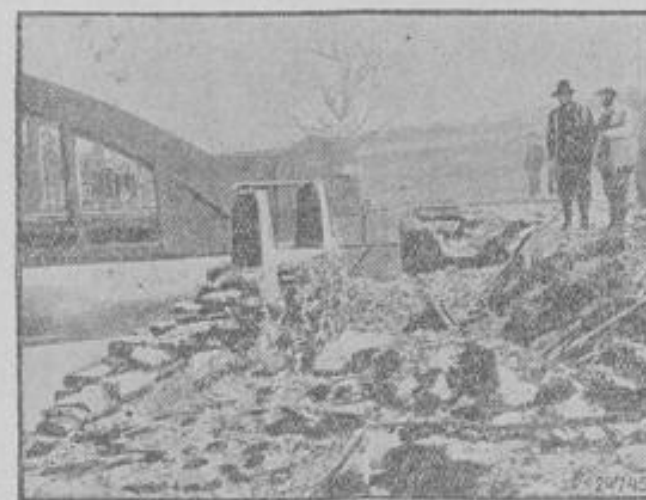
Unwetter über Baden. Unser Bild zeigt das zerstörte Ufer der Oos bei Berghausen in der Nähe von Karlsruhe.
