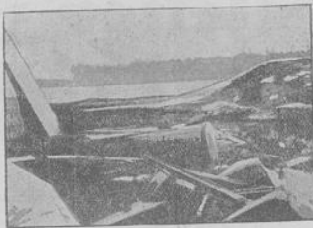
Zur Dammbruchkatastrophe in der Grenzmark. Aus bisher unerklärlichen Gründen wurde die neue Staubedenanlage von Straßforth vom Wasser durchbrochen.
