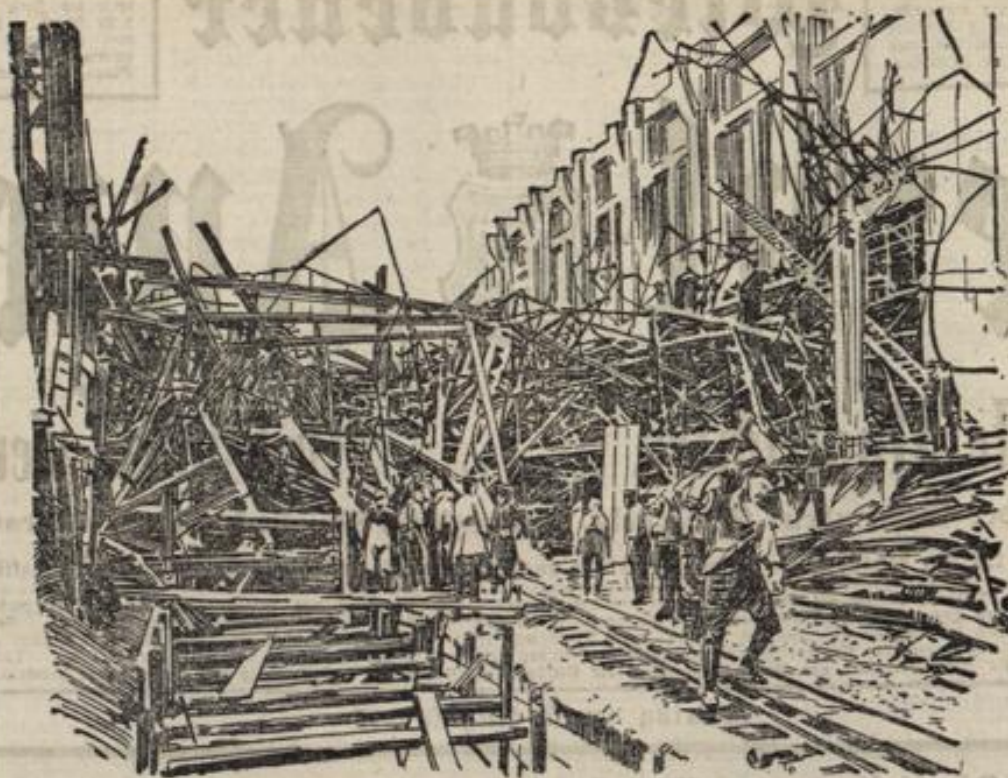
Zur Einsturzgefahr bei Nürnberg. Die zahlreichen Menschenopfer forderte. Das Eisenwerk des im Bau befindlichen Großkraftwerks Franken nach dem Einsturz.
